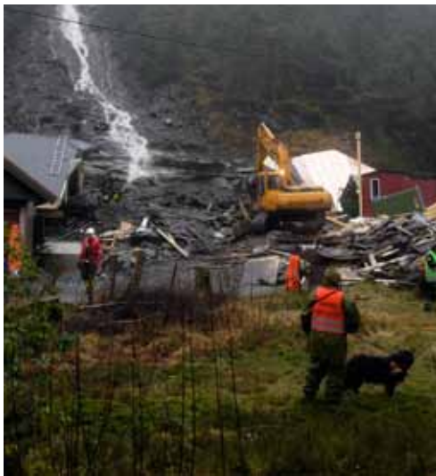
Vest-Norge: Brattlendt terreng, som det er mye av på Vestlandet, er spesielt utsatt for skred. Dette jordskredet i Åsane i Bergen i november 2005 skyldes mye nedbør og oversvømmelse av en elv lenger oppe i fjellsiden. Foto: Marit Hommedal / Scanpix
